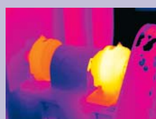
Surriscaldamento del coperchio del cuscinetto
